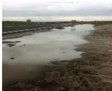
▲ Plasvorming in de berm door te lage infiltratiecapaciteit.
